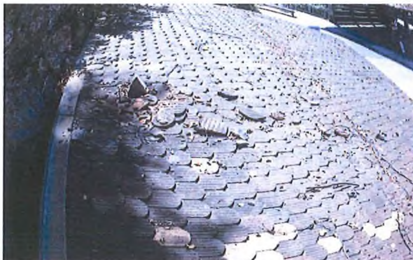
Photo 2 : Vue en direction du Sud : nombreux endroits avec des réparations de tuiles et dernier évènement de chutes de pierres avec tuiles brisées.
